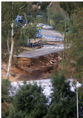
La strada di Poggio dei Pini crollata. Foto Roberto Pili
